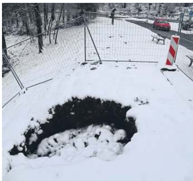
Ein großes Loch tut sich am Wanderparkplatz an der Versetalperre auf. Erste Untersuchungen deuten auf weitere Schäden im Erdreich hin. FOTO: CORNELIUS POPOVICI
