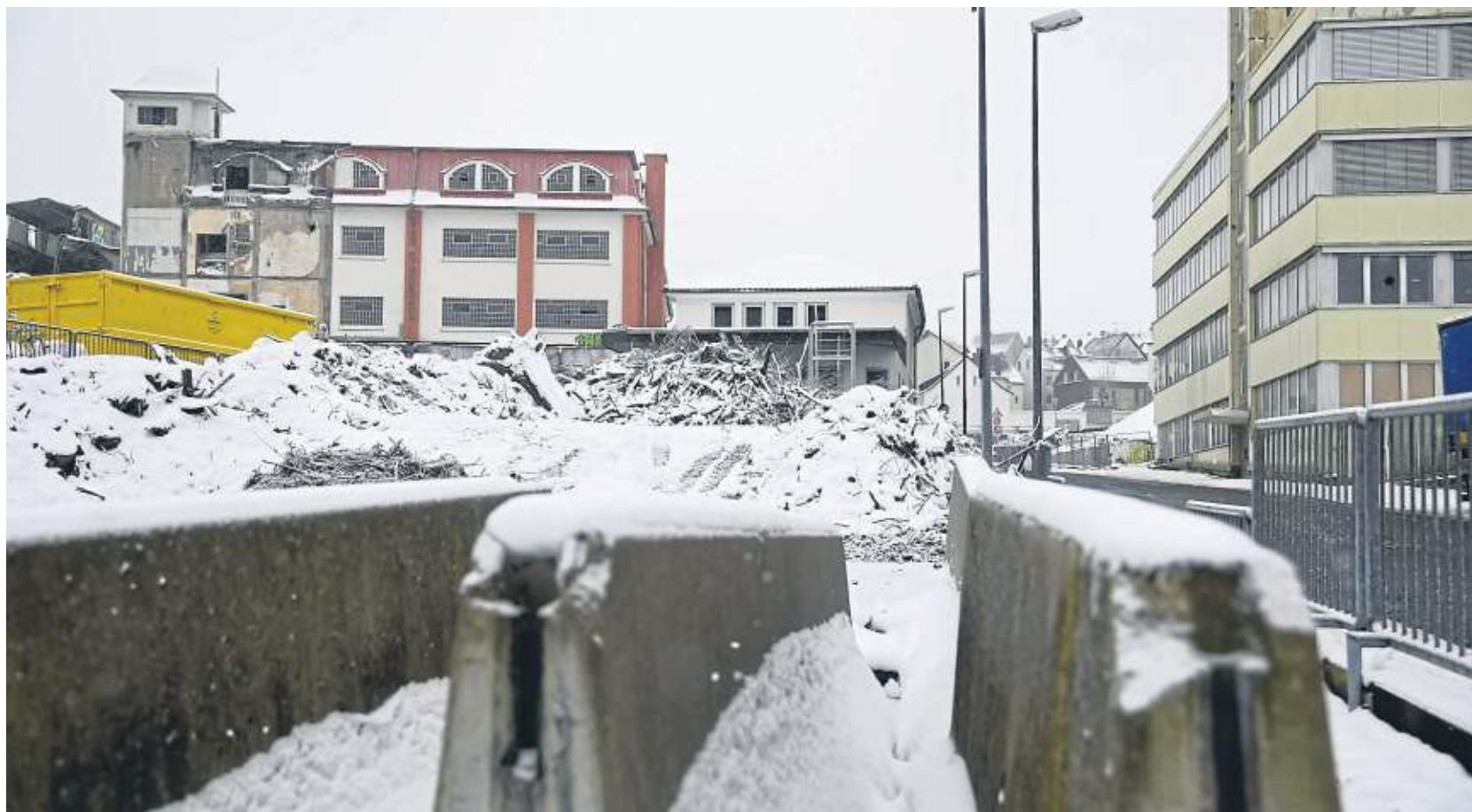
Der ehemalige Standort von Novelis erstreckt sich auf einer Fläche von rund 30 000 Quadratmetern. Der Abriss der alten Gebäude läuft. FOTO: POPOVICI
